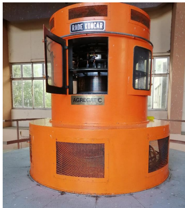
Slika 5: Hidrogenerator C, Hidroelektrane Orlovac prije remonta.
