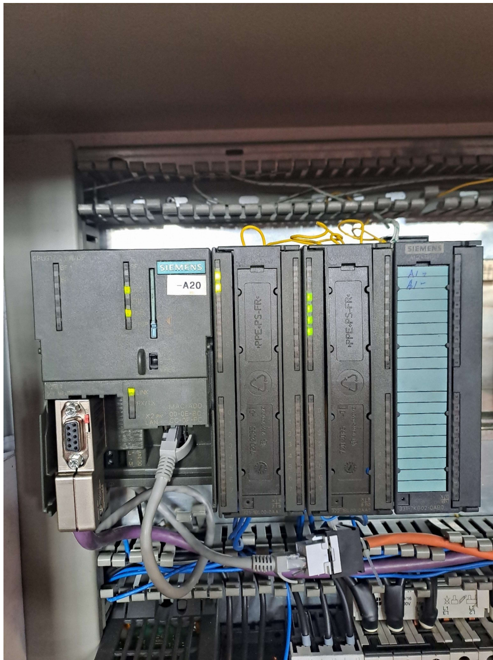
Slika 12. Korišteni PLC Siemens S7-300 (izvorno autor)
