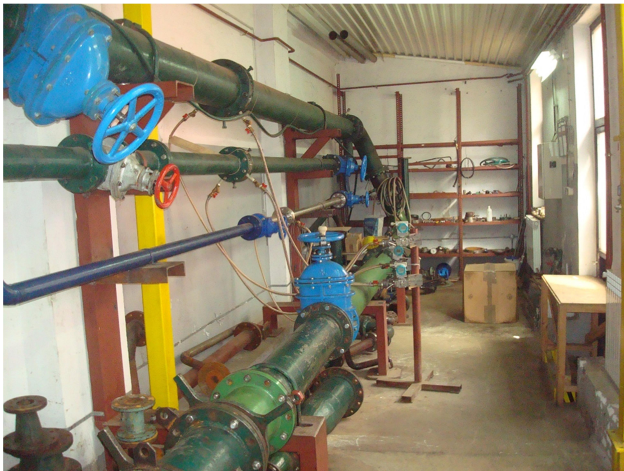
Slika 34 Ispitna stanica za ispitivanje pumpi [izvor: autor]
