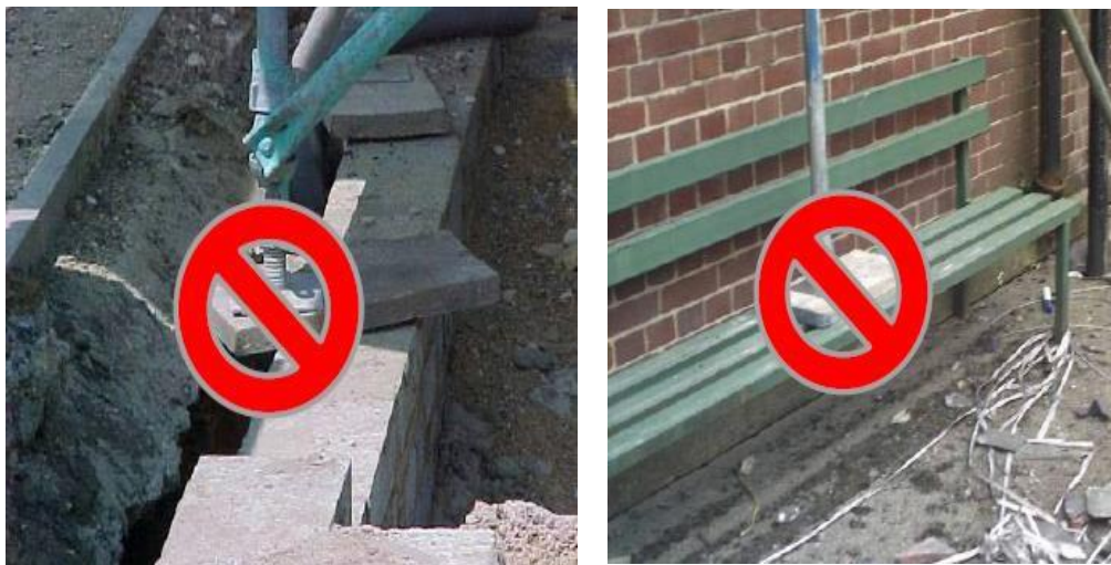
Slika 8. a, b. Nepravilno postavljene baze skele
