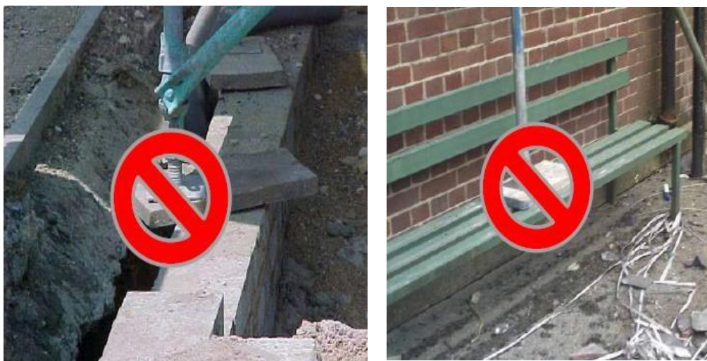
Slika 8. a, b. Nepravilno postavljene baze skele
