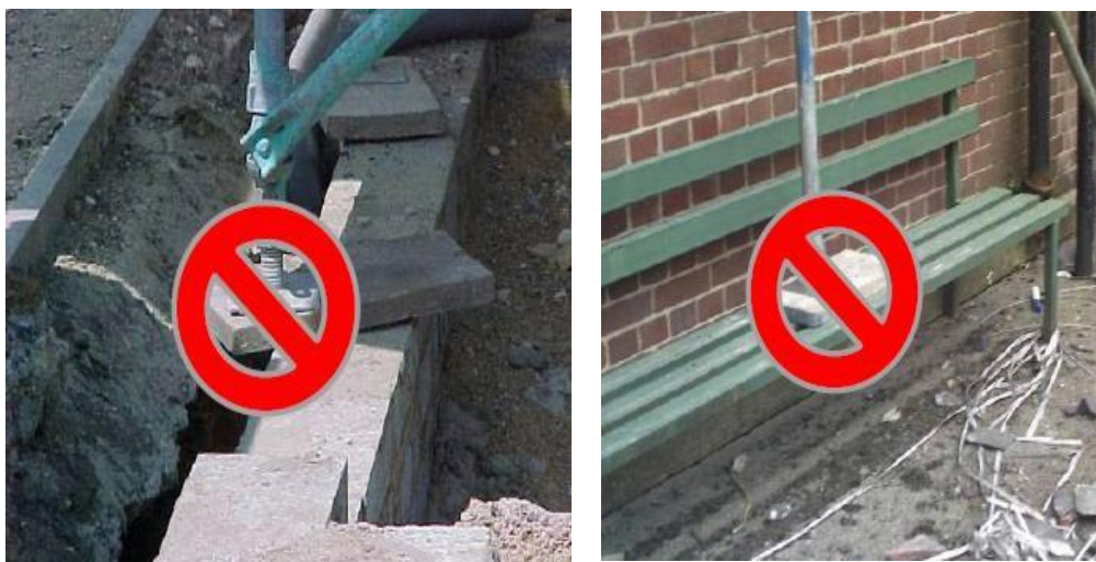
Slika 8. a, b. Nepravilno postavljene baze skele
