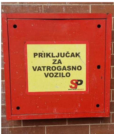
Slika 13. Priključak na hidrantski ormar za vatrogasno vozilo [10]
