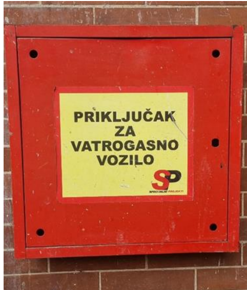
Slika 13. Priključak na hidrantski ormar za vatrogasno vozilo [10]
