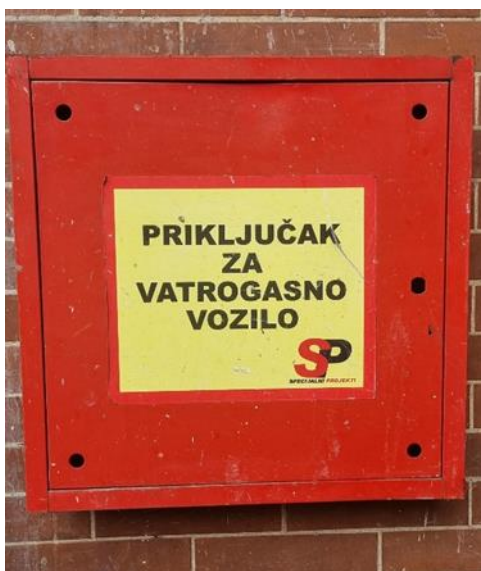
Slika 13. Priključak na hidrantski ormar za vatrogasno vozilo [10]
