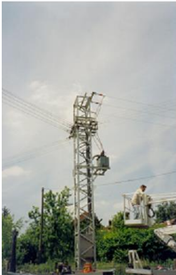
Slika 2: Elektroenergetski nadzemni vodovi i trafostanica
