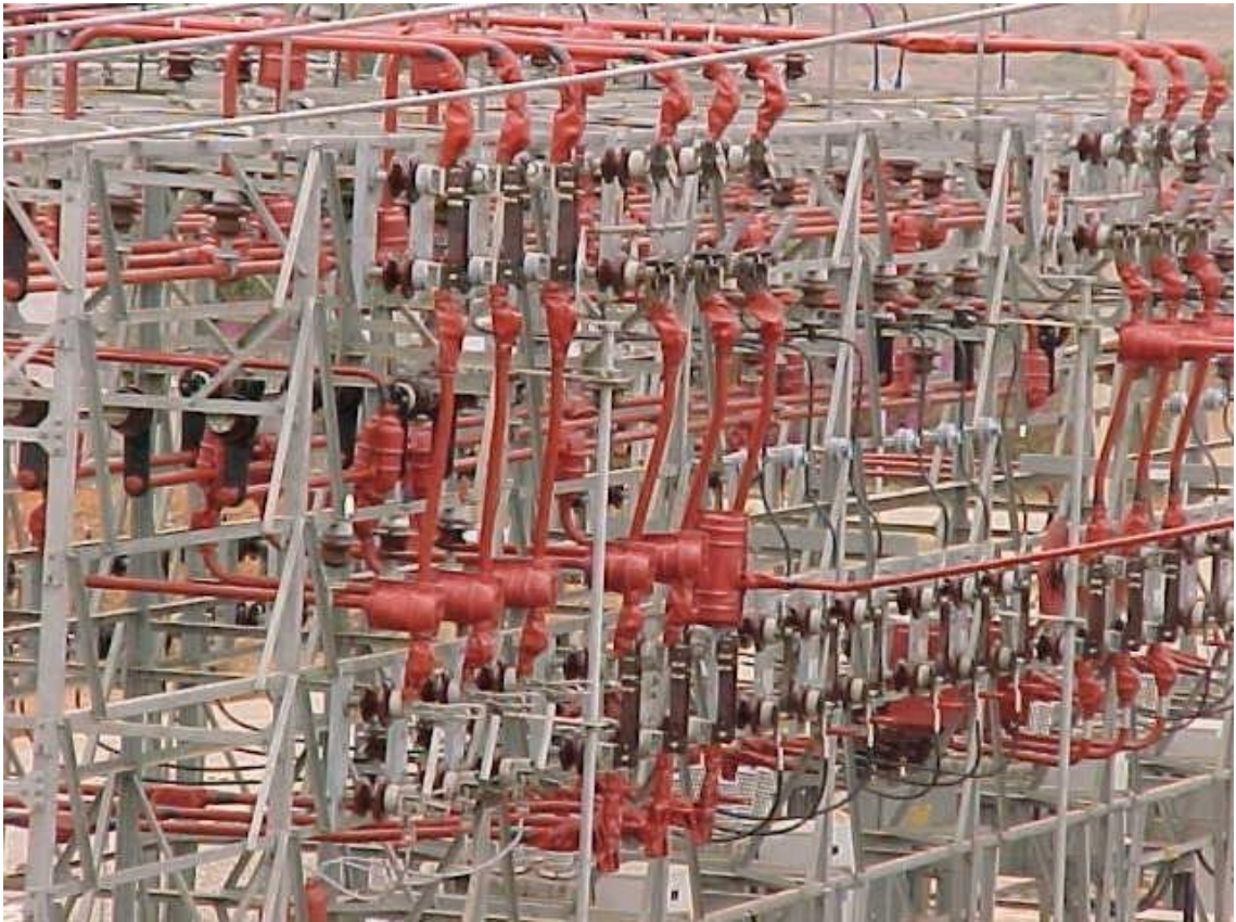
Slika 22: Izolirano elektroenergetsko postrojenje
