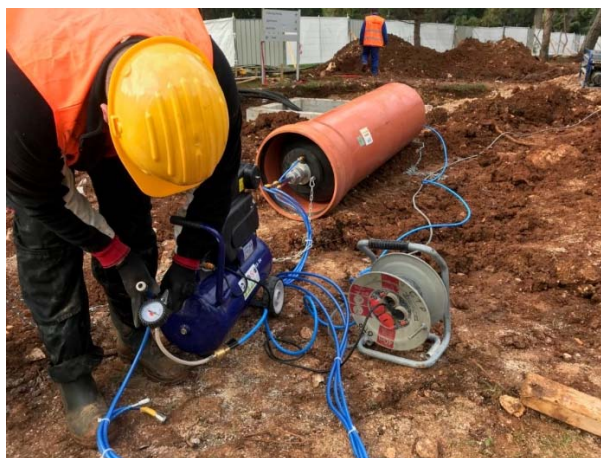
Slika 43: Kompresor za tlačno ispitivanje cijevi [34]
