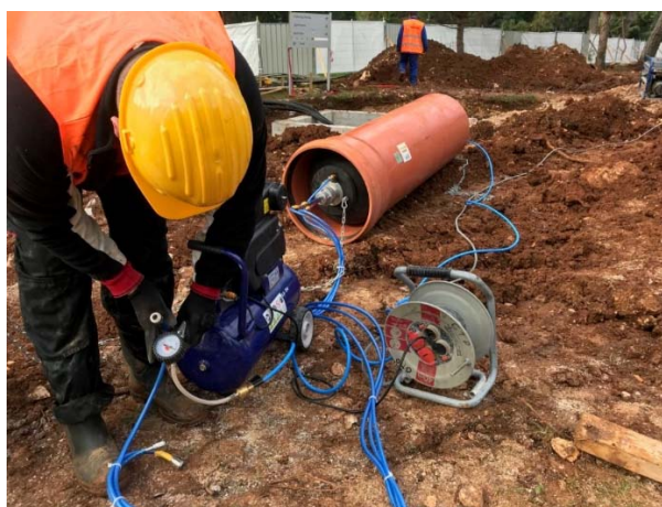
Slika 43: Kompresor za tlačno ispitivanje cijevi [34]
