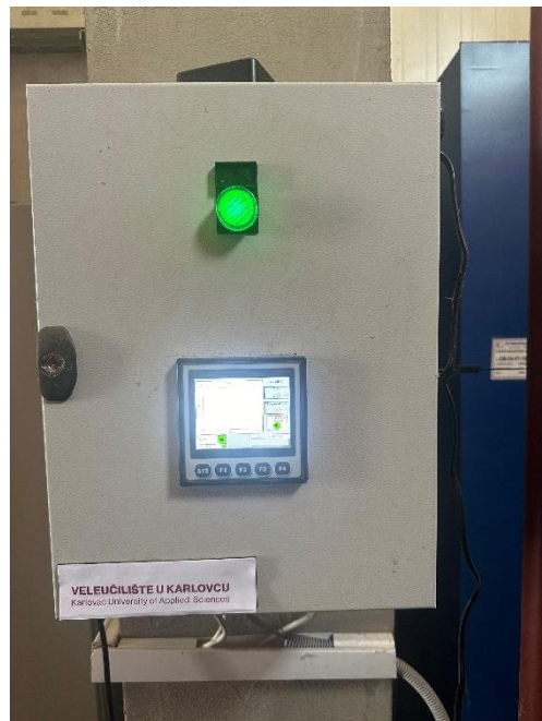
Slika. 9 Razvodni ormarić Izvor: Autor
