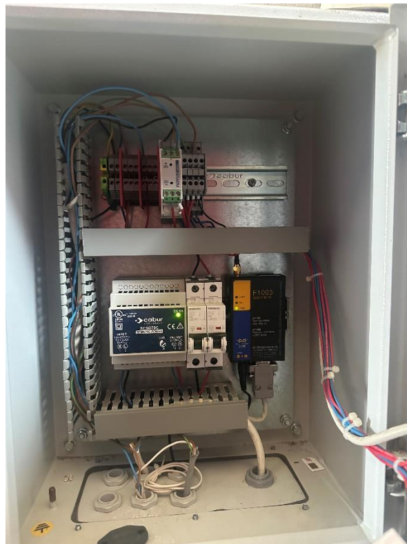
Slika. 12 Unutrašnjost razvodnog ormarića Izvor: Autor
