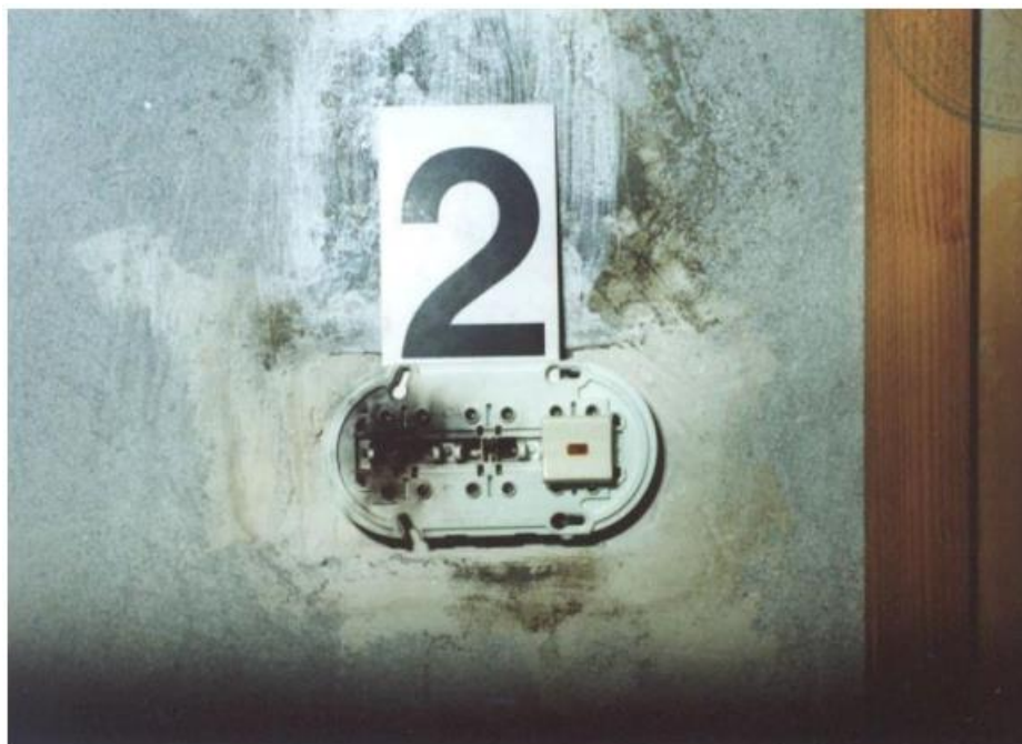
Slika 16. Karbonizacijsko začađenje na višestrukome prekidaču [24]
