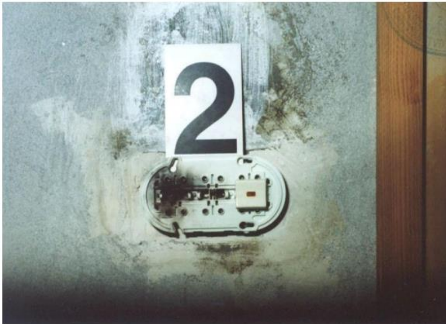
Slika 16. Karbonizacijsko začađenje na višestrukome prekidaču [24]
