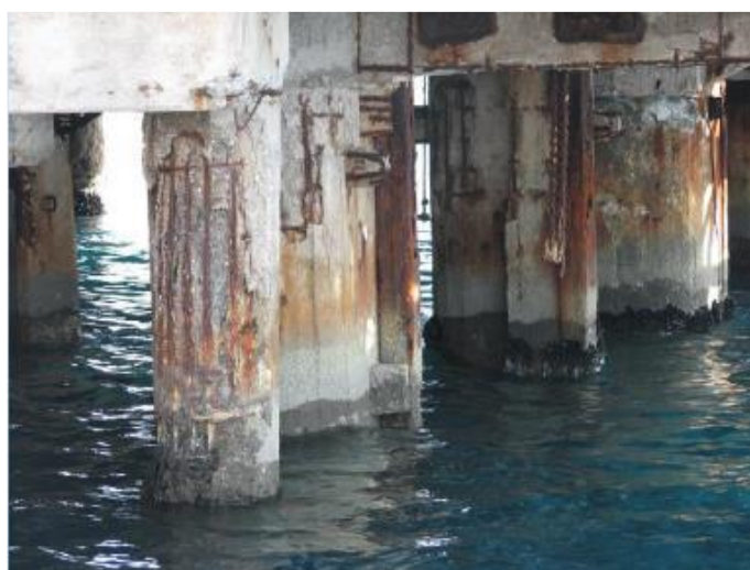
Slika 11. Korozija u betonu. [12]
