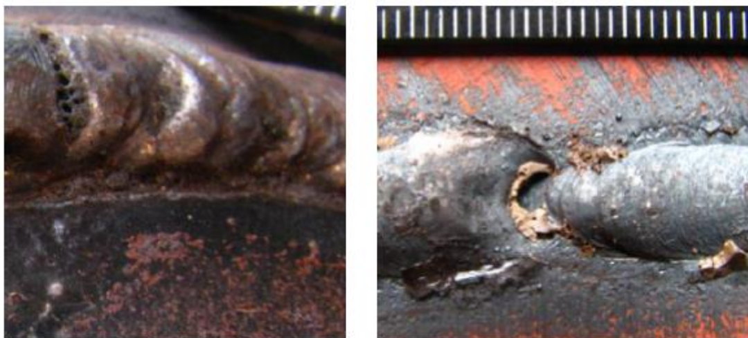
Slika 59. Prikaz grešaka zavarenih spojeva. [12]
