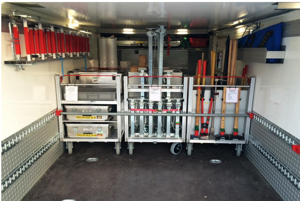
Slika 9 Oprema u box kolicima [11]
