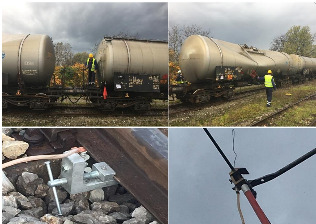
Slika 15 .Uzemljenje željezničkih vagona
