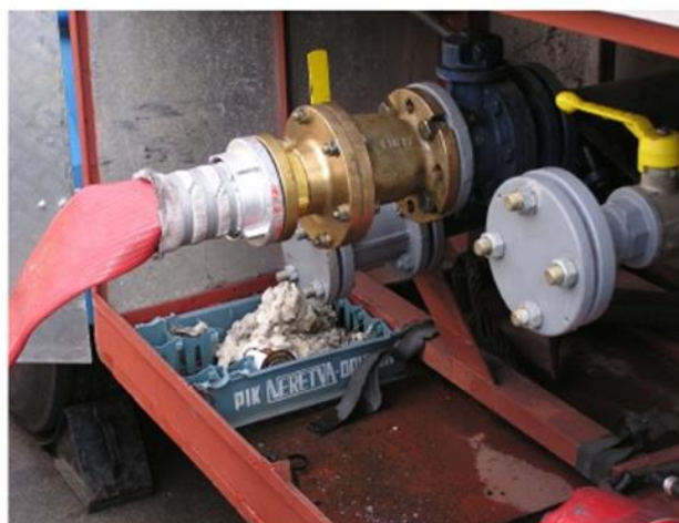
Slika 14. Spajanje tlačne vatrogasne cijevi pomoću adaptera na tekuću fazu [8]
