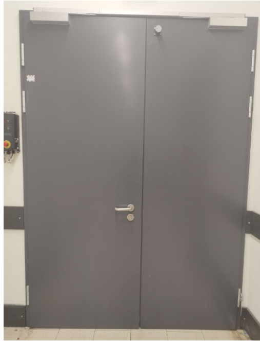
Slika 7. Prikaz protupožarnih vrata u trgovini
