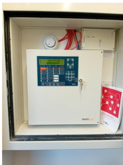
Slika 45. Vatrodojavna centrala u trgovačkom centru Stop & Shop [21]
