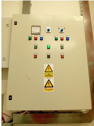
Slika 51. Elektro upravljački ormar u Stop&shop centru [21]
