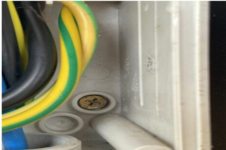
Slika 11. Nakupljena vlaga i korozija na vijku koji nije zatvoren poklopcem ili silikonom [7]
