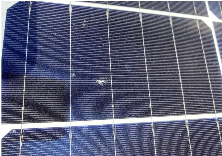
Slika 20. Oštećenje na prednjoj strani fotonaponskog panela – pukotine su točke visokog otpora u ćeliji i mogu dovesti do vrućih točaka [6]
