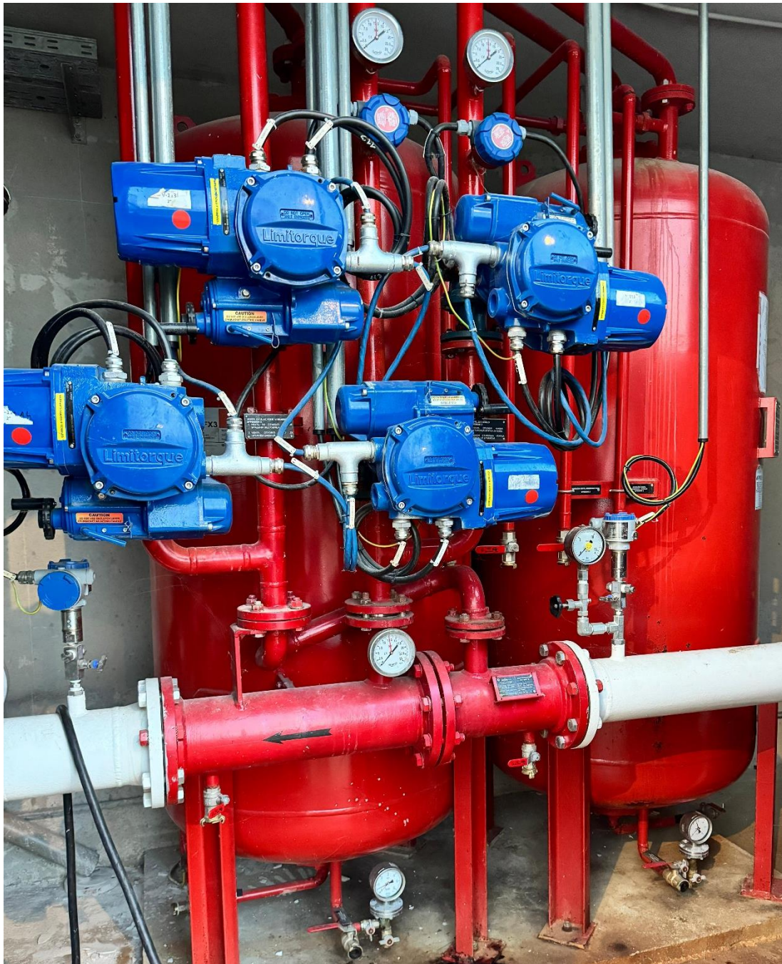
Slika 14. Spremnici s pjenilom od stabilnog sustava [19]
