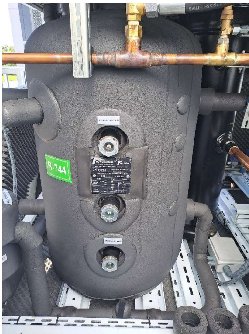
Slika 25. Pozicije kontrolnih stakala na ugrađenom spremniku
