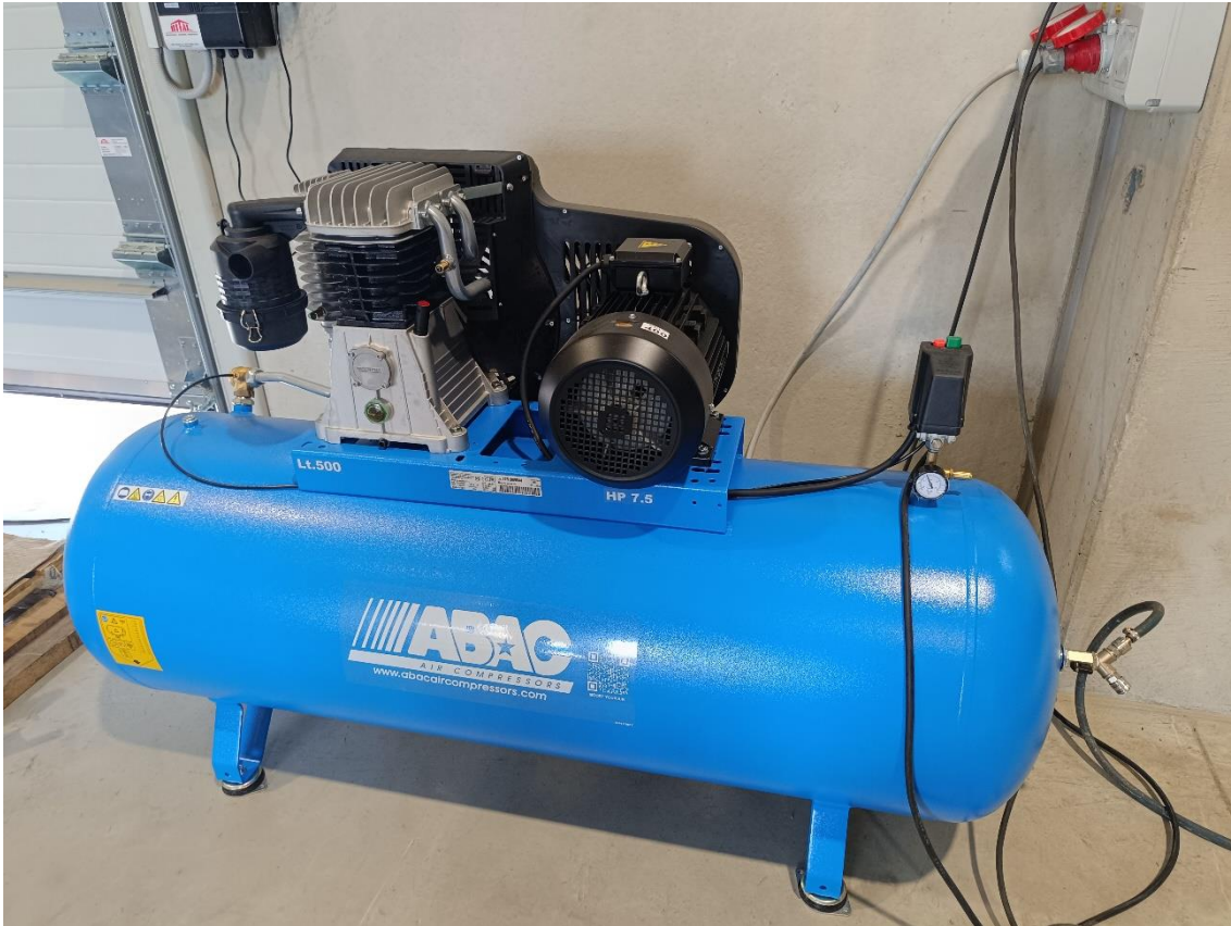
Slika 9. Klipni kompresor tvrtke "METALLIS d.o.o."
