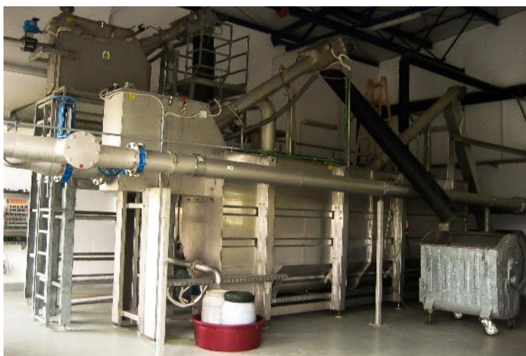
Slika 3: Mehaničko pročišćavanje i fekalna stanica (autorske slike)
