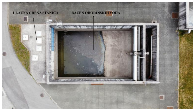
Slika 2: Ulazna crpna stanica i bazen oborinskih voda (autorske slike)
