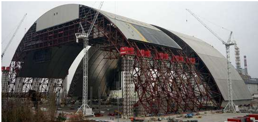
Slika 19: Čelična zaštita iznad reaktora 4 u Černobilu [11].
