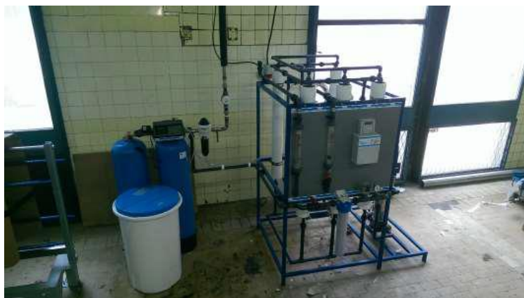
Slika 17. Sustav za obradu vode
