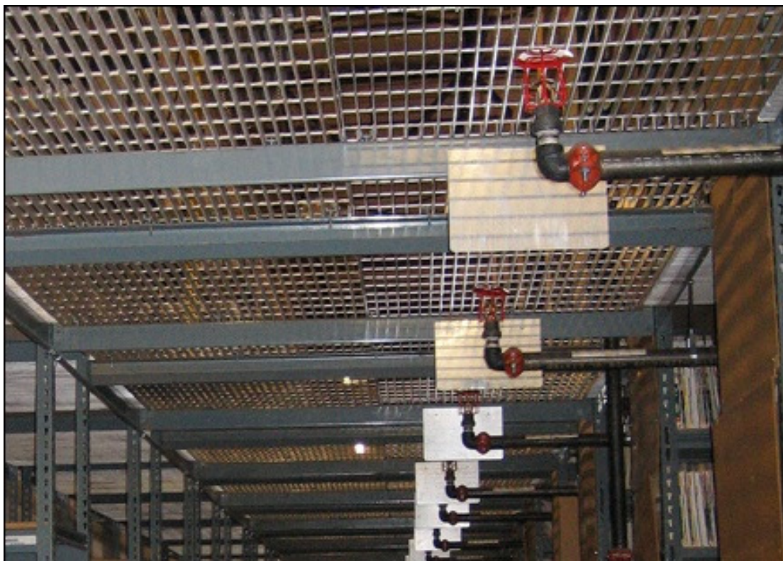
3. Slika: Primjer - regalno skladište s ugrađenim sprinkler mlaznicama [14]
