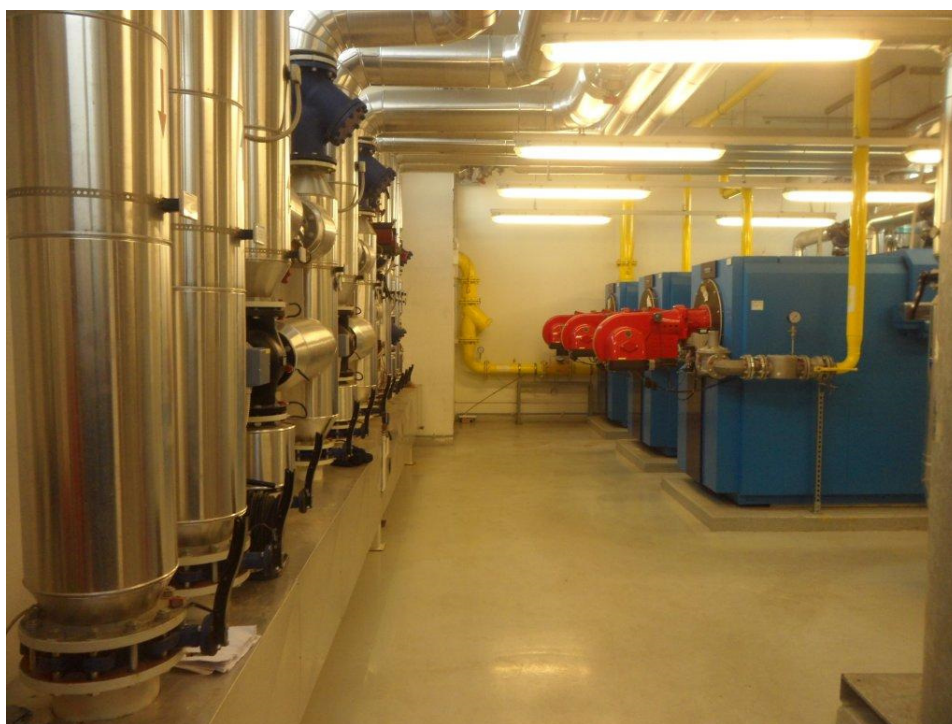
12. Slika: Primjer plinske kotlovnice snage od 3 MW
