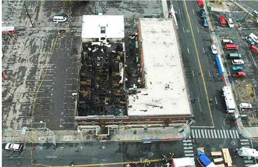
Slika 15: Razmjeri štete od požara – sjeverno krilo [23].
