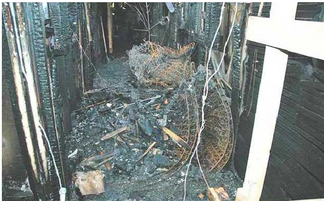
Slika 16: Prikazuje ostatke madraca u hodniku na 2. katu [23].
