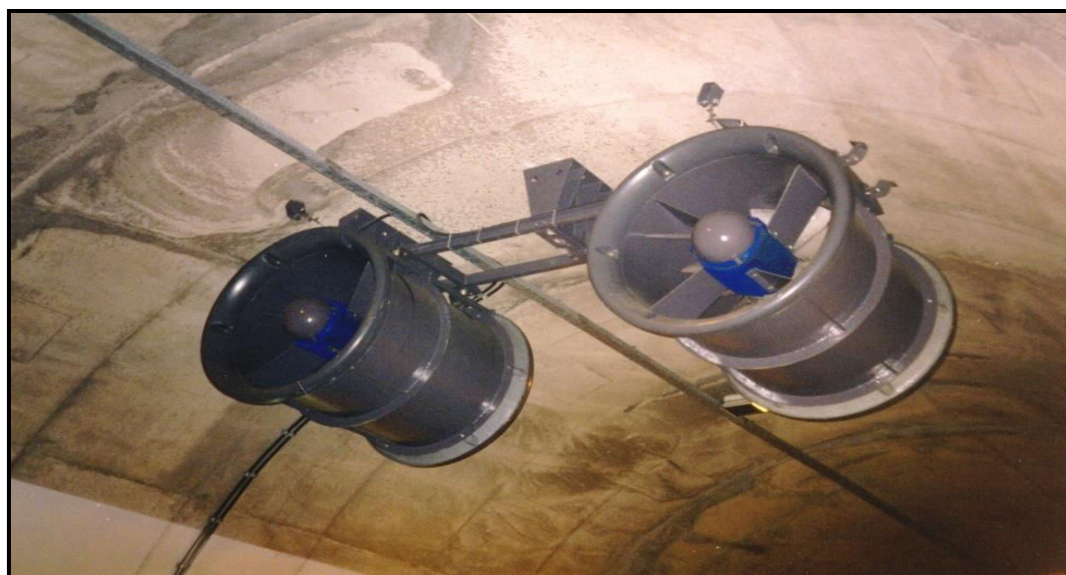
Sl. 13. Ventilatorska baterija u Tunelu mala Kapela [7]
