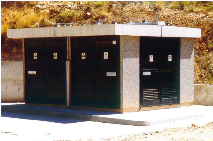
Sl. 15. Uljna transformatorska stanica [9]
