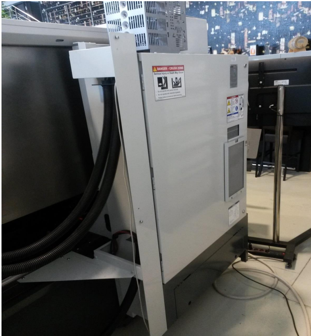
Slika 21. Sigurnosni ormar električne energije
