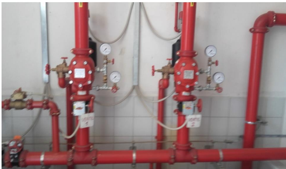
Slika 22. Splinkler instalacija [izrada autora]
