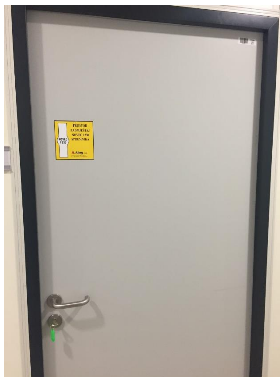
Sl. 21. Ulaz u prostor za smještaj spremnika s NOVEC-om 1230 [25]
