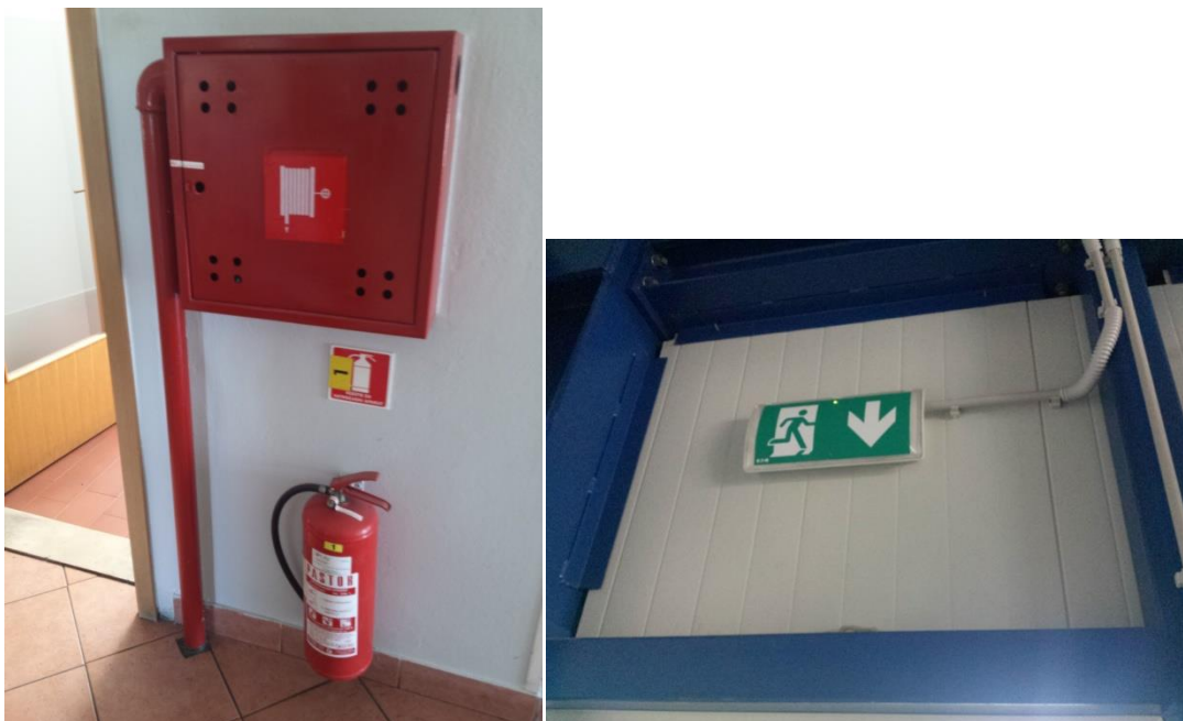
Slika 3. Unutarnji hidrantski ormarić, vatrogasni aparat i panična rasvjeta
