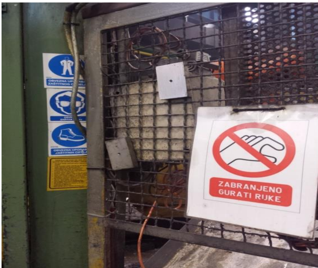
Slika 6. Postavljeni sigurnosni znakovi na strojevima i uređajima
