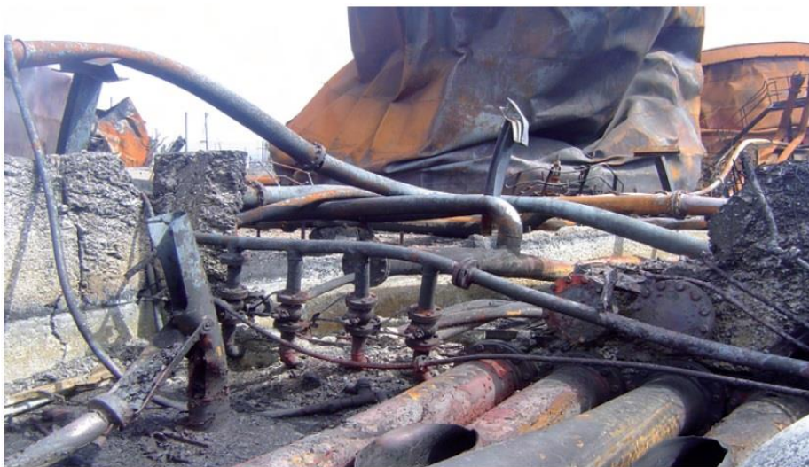
Slika 24: Prikaz mjesta razaranja zida sabirnog prostora zbog termičkog rastezanja cijevi pod utjecajem visokih temperatura u požaru [6].
