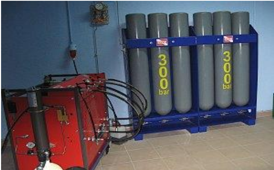
Sl. 7. Visokotlačne boce banke zraka [11]
