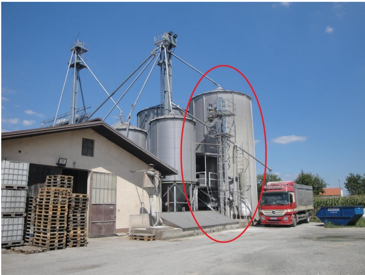
Sl.14. Komora silosa na kojoj je izbio požar [14]
