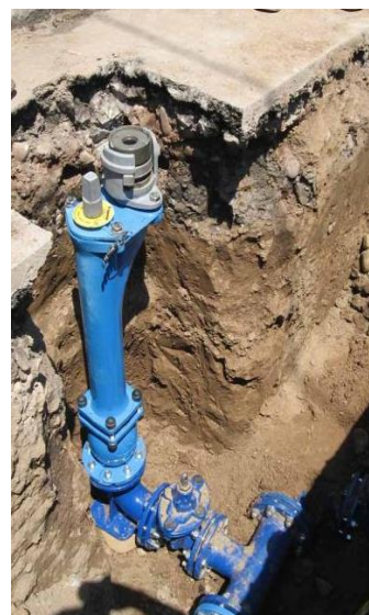
Sl. 8. Podzemni hidrant [16]
