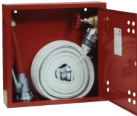
Sl. 9. Zidni hidrantski ormarić ZHO-1[18]
