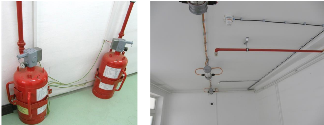
Sl.5 Stabilni sustav za gašenje požara FM 200[16]
