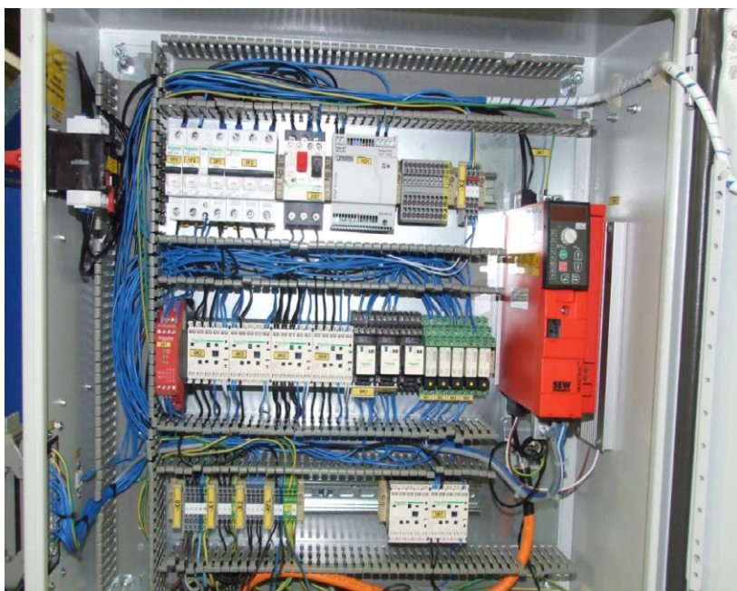
Slika 1.48. Elektroarmarić pogled iznutra
