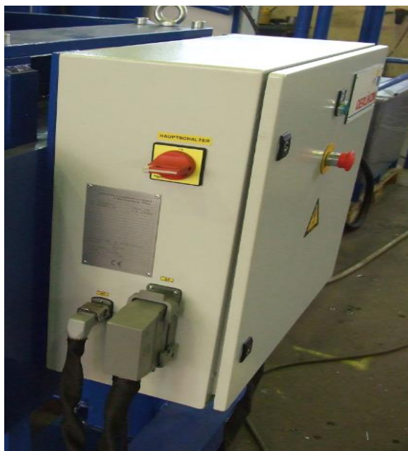
Slika 1.47. Elektroarmarić pogled izvana
