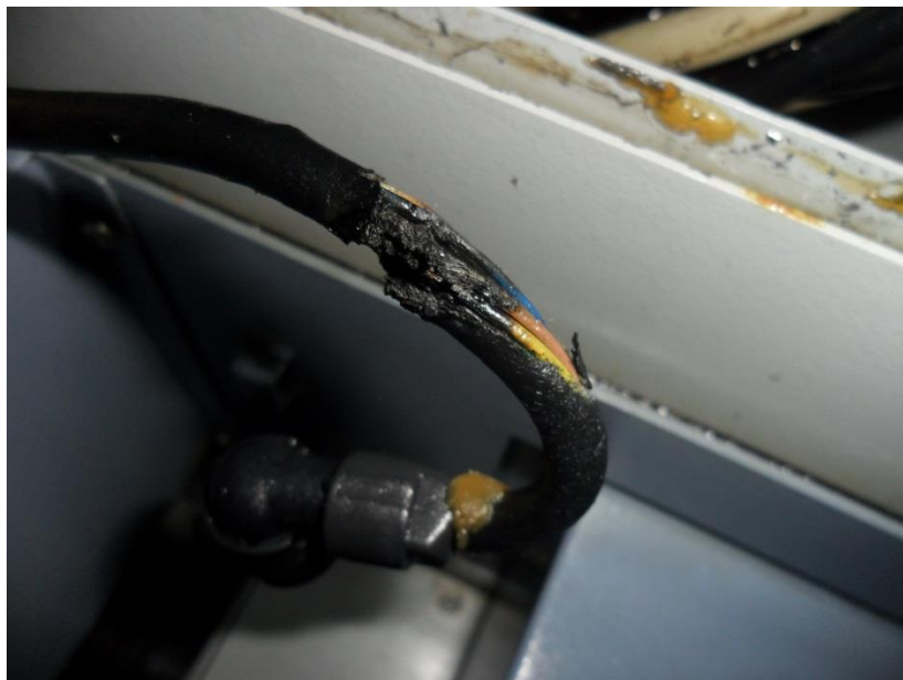
Slika 16: Oštećenje kablova na pregibnim dijelovima
