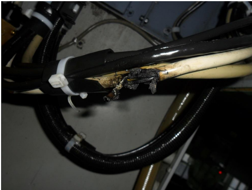
Slika 17: Oštećenje kablova na pregibnim dijelovima
