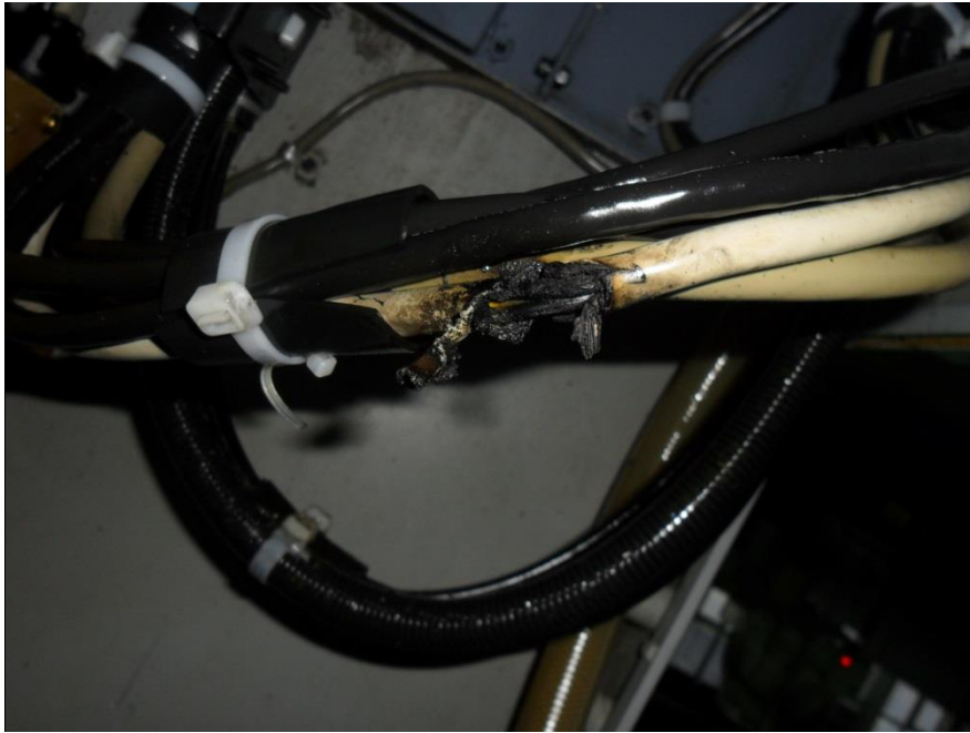
Slika 17: Oštećenje kablova na pregibnim dijelovima
