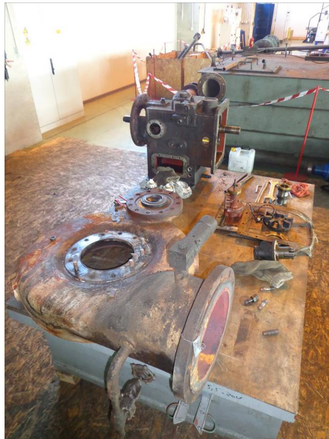
Fotografija 4.2 Defektaža kućišta turbine, SLB-a i GUP-e
