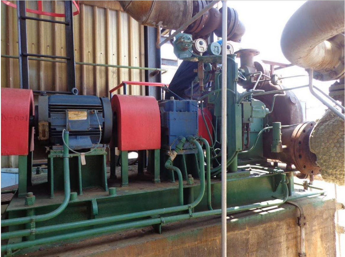
Fotografija 3.3 Stanje turboagregata prije demontaže
