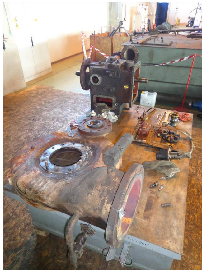
Fotografija 4.2 Defektaža kućišta turbine, SLB-a i GUP-e
