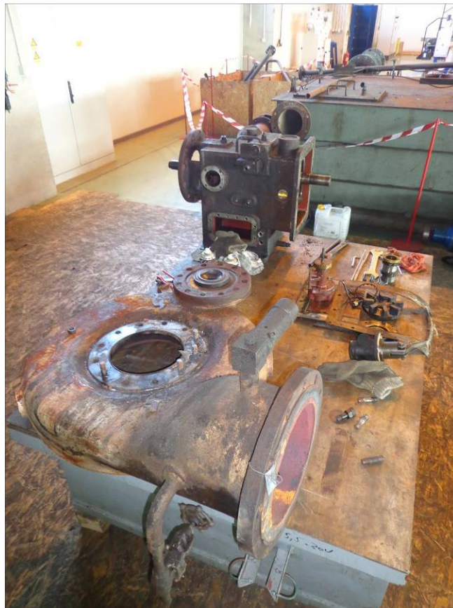
Fotografija 4.2 Defektaža kućišta turbine, SLB-a i GUP-e
