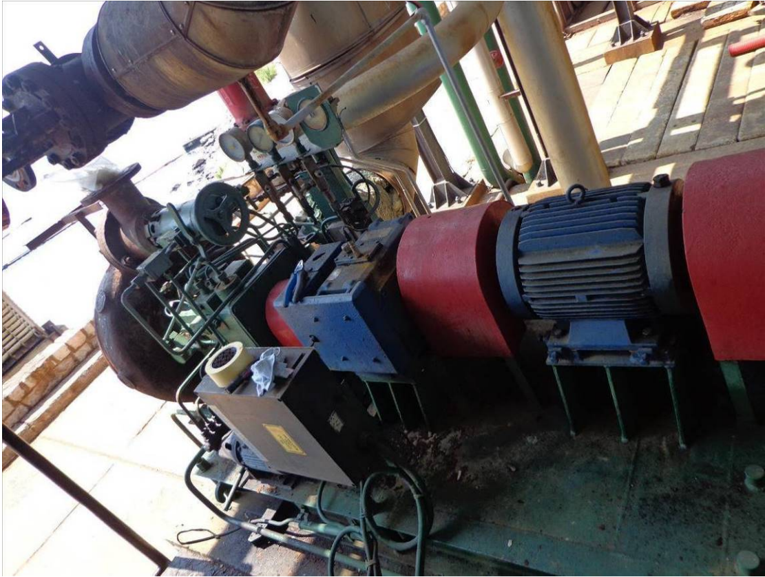
Fotografija 3.1 Stanje turboagregata prije demontaže
