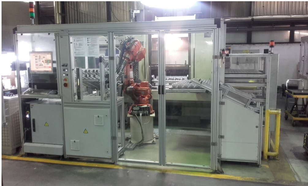
Slika 33. Prikaz zaštitne ograde
