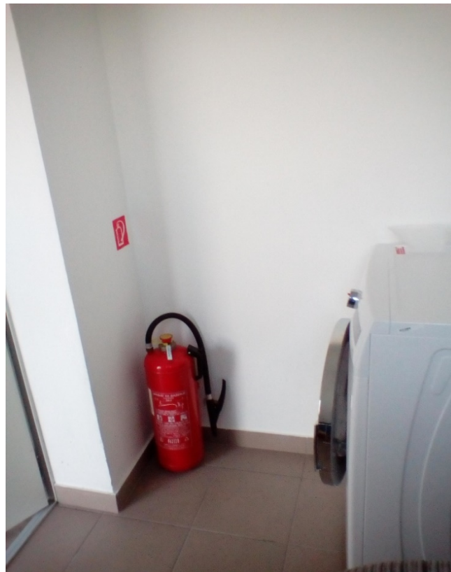
Slika 23. Vatrogasni aparat postavljen u praonici [14]
