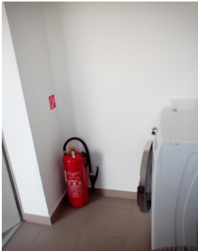
Slika 23. Vatrogasni aparat postavljen u praonici [14]
