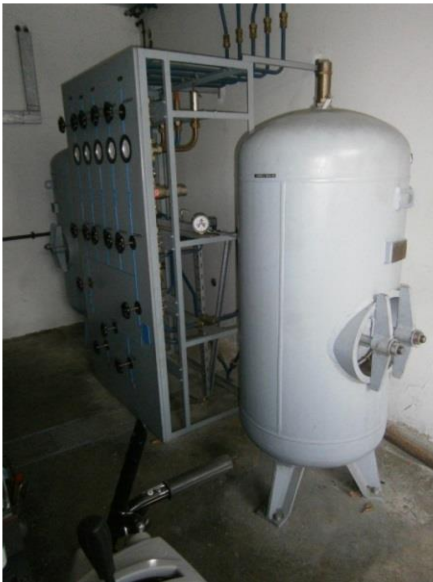
Slika 16. Spremnik zraka s razdjelnikom
