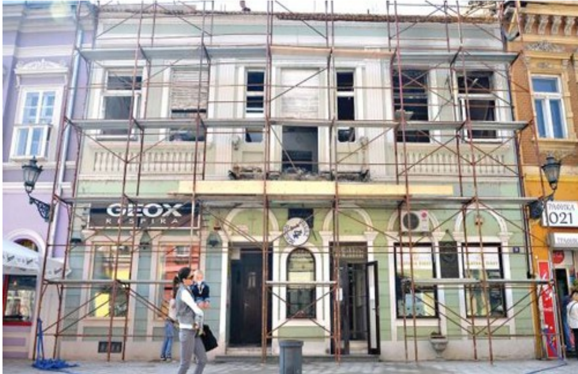
Slika 5 : Nepropisno postavljena skela (zadaća komunalnog redara) 5
