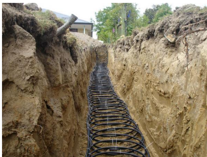
Slika 17. Spiralni kanalni kolektor u jarku [4]
